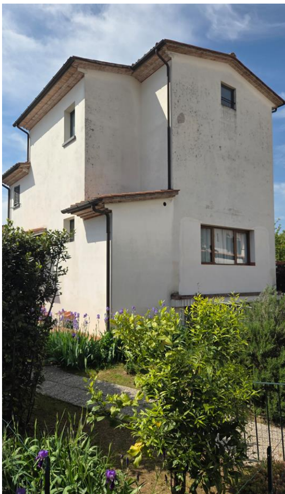
Foto 11: Foto dello stesso edificio dove emergono 3 altezze diverse (AS 047013000010655600)
